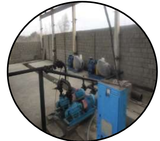
Водоснабжение Насосная станция СЭЗ «Панч»
