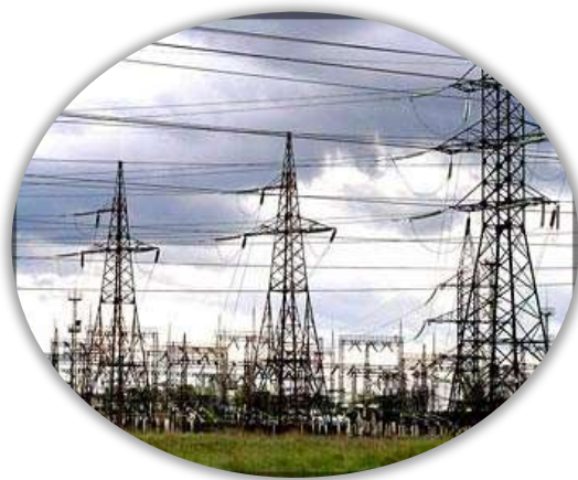
Подстанция Карадум имеет 110/35/6 кВ S=16 мВА
