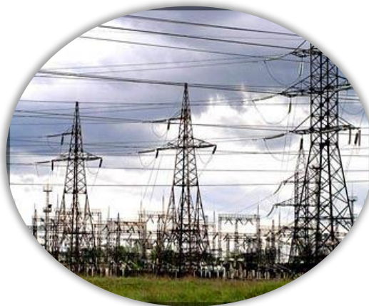
Подстанция Карадум имеет 110\35\6 28,5 мГВ,\ электроэнергии
