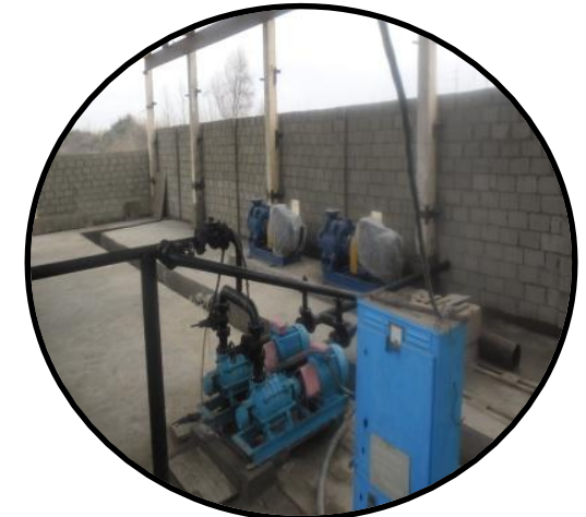
Водоснабжение Насосный станция СЭЗ «Панч»
